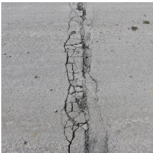
Figura 3.28 Desplazamiento longitudinal entre el puente y el talud de acceso en el puente El Ticuiz
