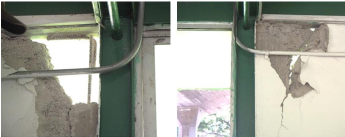
Figura 3.3 Fracturamiento sistemático de muros en la dirección longitudinal del edificio G
