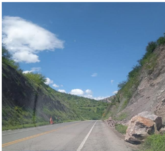
Figura A.5 Roca retirada de la autopista Pátzcuaro-Lázaro Cárdenas (SICT, 2022)
