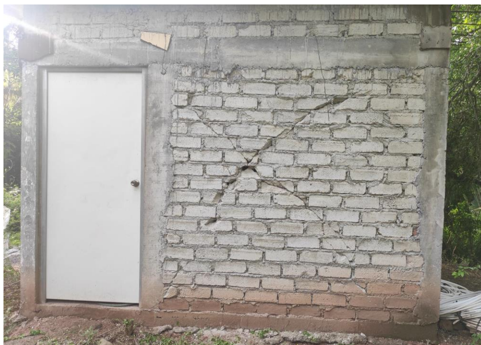
Figura 9.7a Estructura de mampostería confinada con daño menor reparable. Fuente: CENAPRED (2022)
