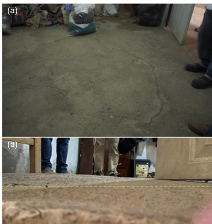
Figura 3.34 a) Abultamiento y fracturamiento en el piso y b) vista a nivel del suelo
