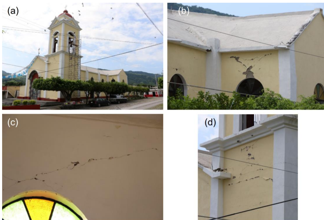
Figura B.20. Daños en la iglesia de Pueblo Juárez, Colima
