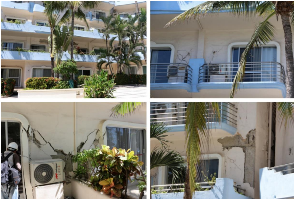
Figura B3. Fachada con daños en la zona de albercas, hotel Gran Pacífico
