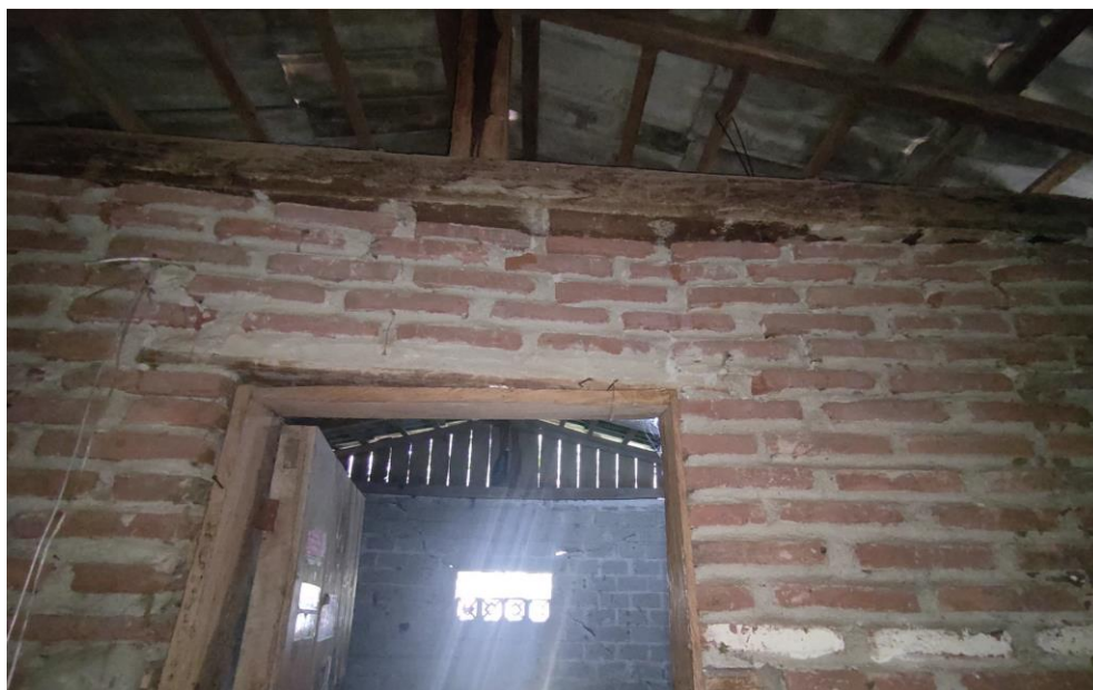
Figura 9.6 Muro con desplazamientos fuera del plano. Fuente: CENAPRED (2022)
