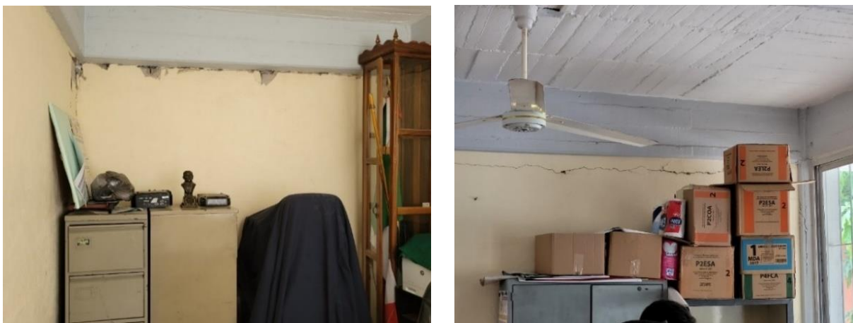
Figura 4.2 Agrietamientos horizontales y verticales en los bordes de los muros divisorios
