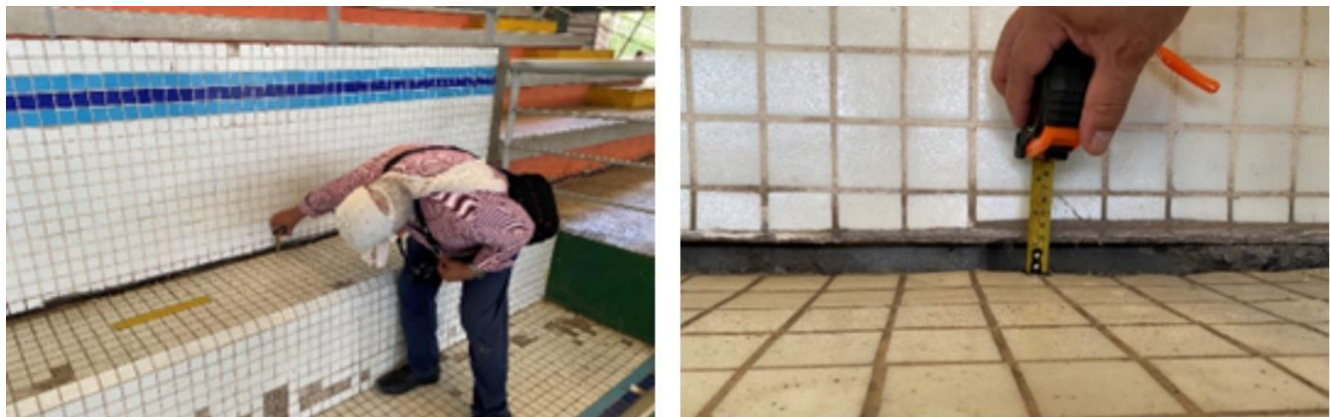
Figura 3.7 Asentamiento en la primera fila de las gradas Sur
