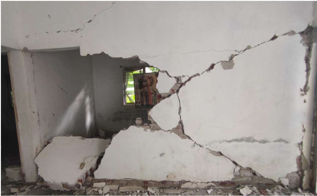
Figura 9.9 Colapso de muro con agrietamiento por tensión diagonal y posterior falla fuera del plano
