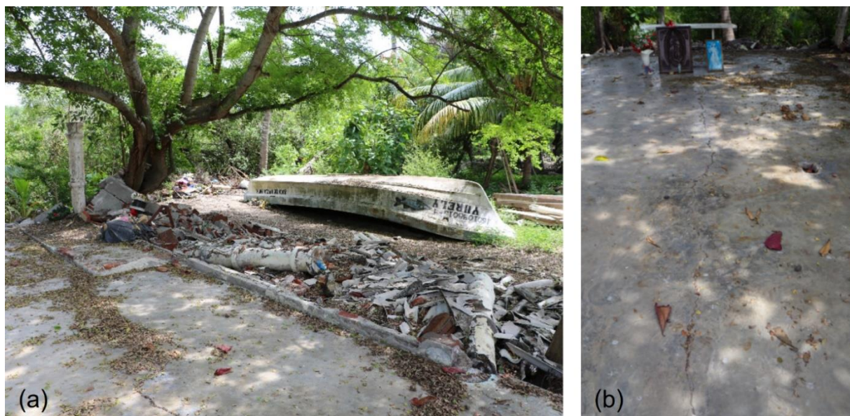
Figura 3.39 a) Estructura de la iglesia colapsada y b) firme abultado y agrietado
