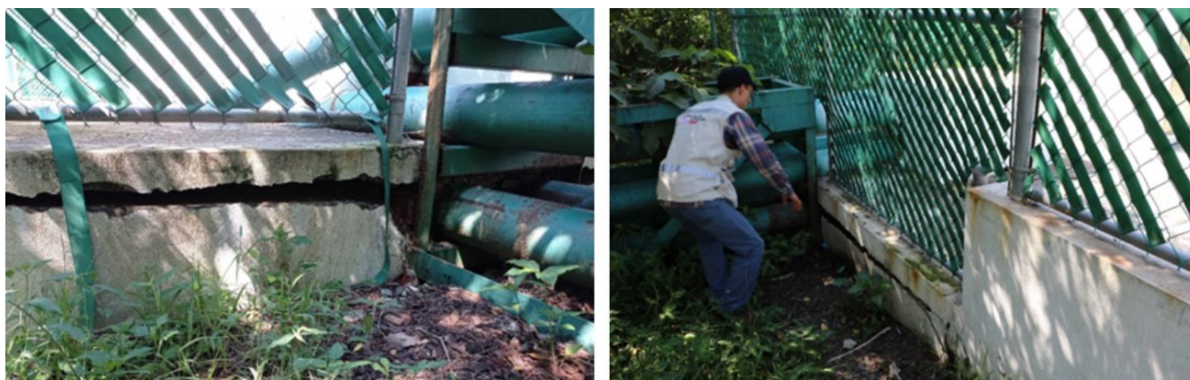
Figura 3.9 Agrietamiento debido al asentamiento diferencial del terreno en una subestación de transformación
