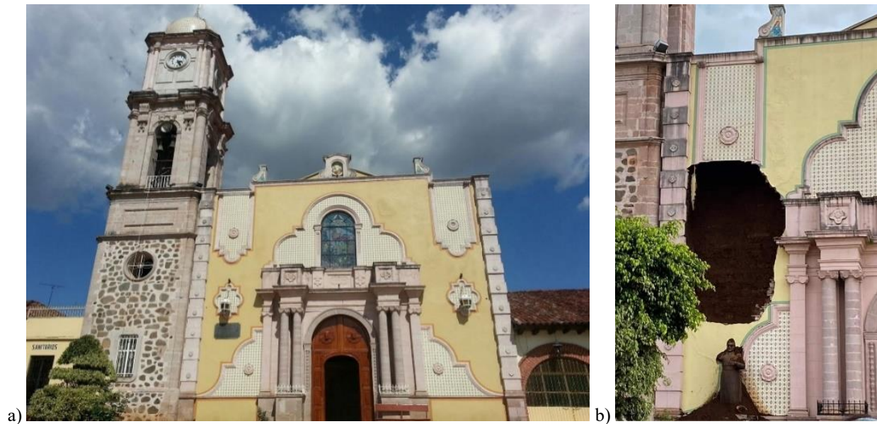
Figura 5.5 Fachada principal (Diócesis, 2023): a) antes del sismo; b) daños por el sismo
