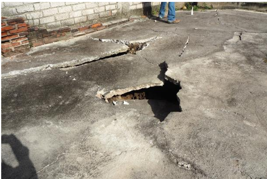
Figura 3.35 Emersión de fosa séptica que causó el fracturamiento del firme de concreto no reforzado, Figura 3.1a sitio 17
