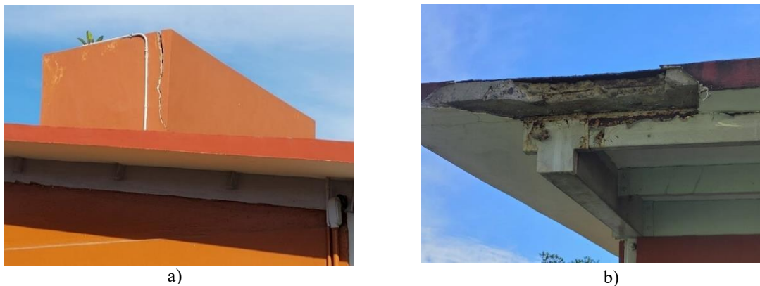
Figura 4.13 a) Agrietamiento vertical en muros por falta de dalas de cerramiento, y b) Daño en losa por inadecuado armado de acero de refuerzo
