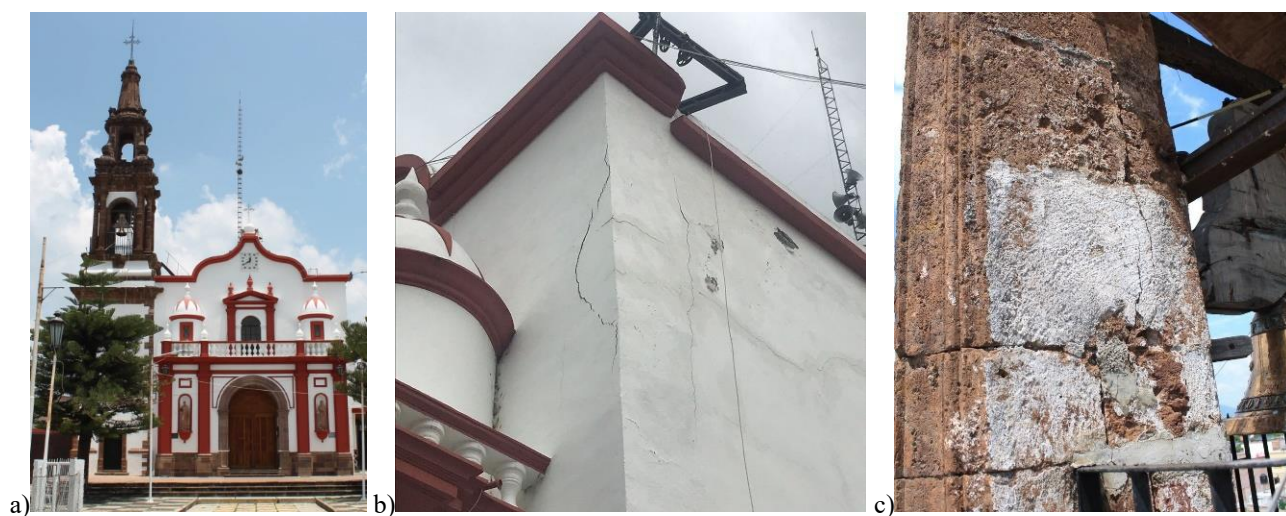
Figura 5.4 Iglesia de Tangamandapio (Diócesis, 2023): a) fachada principal, b) daño en esquinas y conexiones entre muros, c) daños en pilastras del primer cuerpo del campanario
