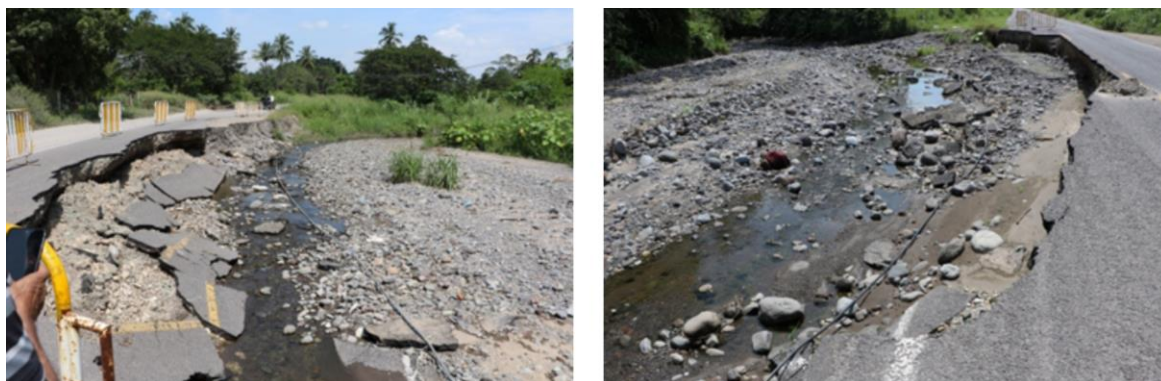
Figura 3.21 Daños en la carretera Coquimatlán – Jala
