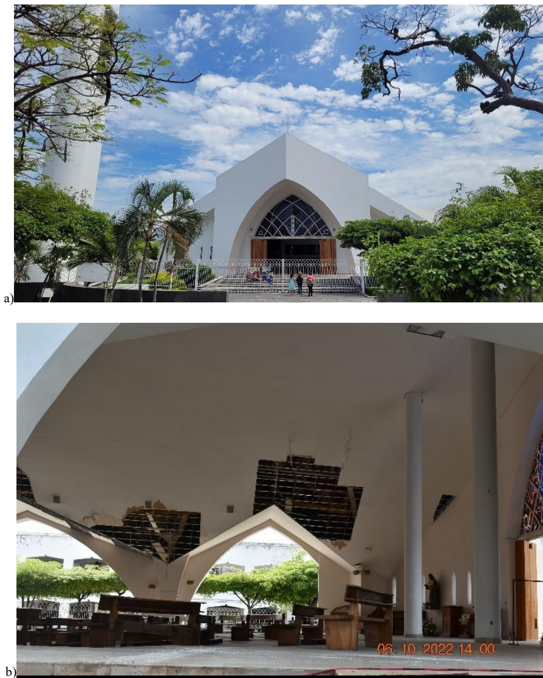
Figura 5.11 Santuario de la Virgen de la Candelaria, Tecomán: a) fachada, b) daño en recubrimiento de techumbre, c) daño en uniones muro – techo (continúa)
