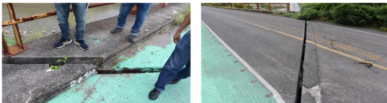
Figura 3.19 Separación en la junta entre dos cuerpos del puente
