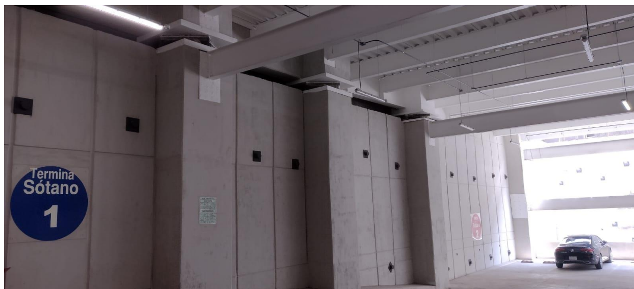
Figura 8.7 Fotografía de aisladores en la nueva torre de hospitalización del Hospital Salvador Zubirán
