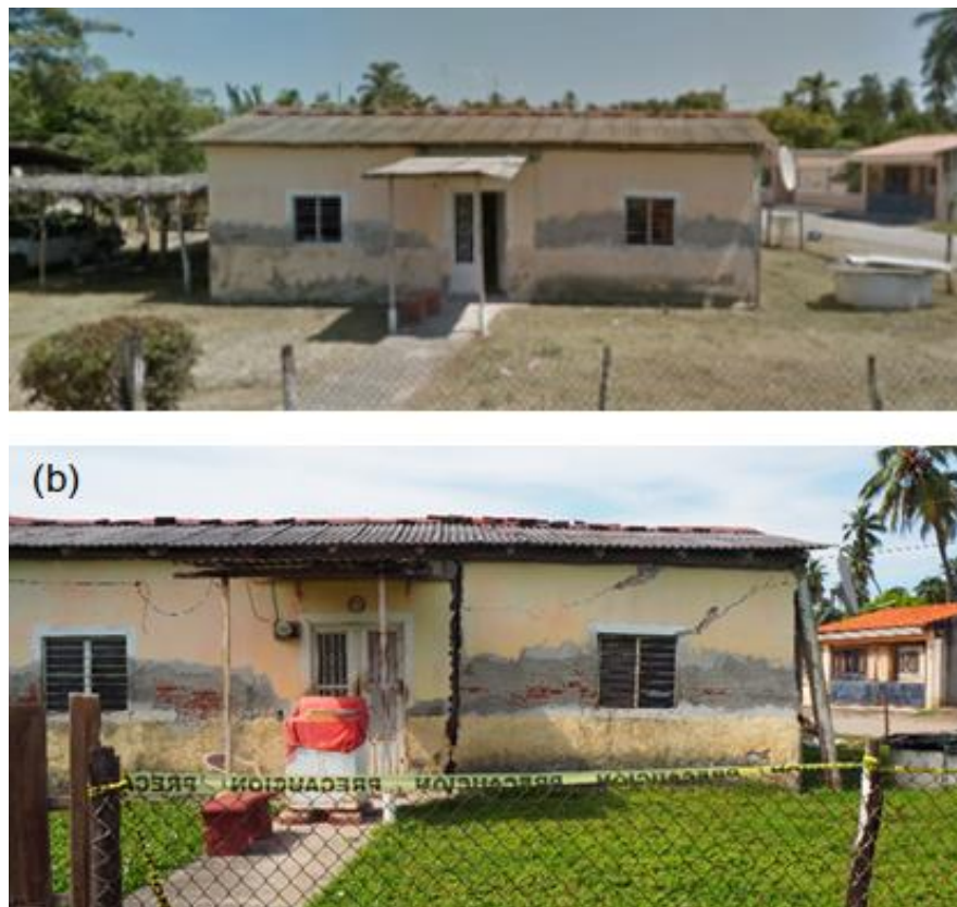
Figura 3.29 Vivienda con marcado asentamiento diferencial hacia la esquina a) antes del sismo y b) después del sismo. Fuente a): Google, 2024
