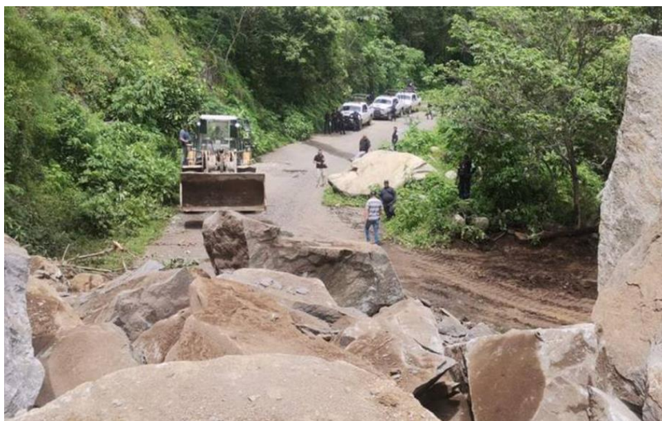
Figura A.2 Derrumbe en la carretera Chinicuila-Coalcomán (El Sol de Morelia, 2022)
