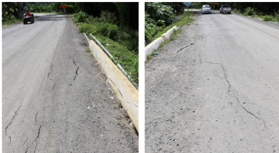
Figura 3.26 Grietas y asentamientos en el pavimento debidas al desplazamiento lateral
