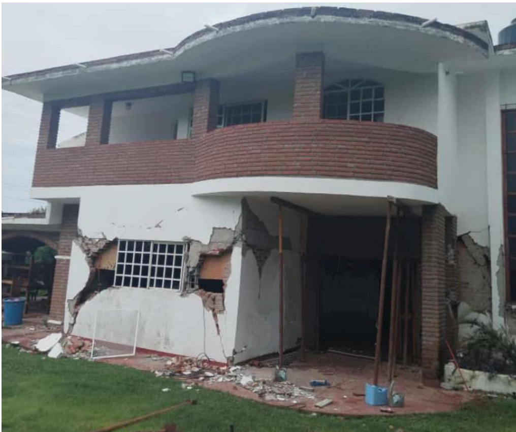
Figura 9.10 Vivienda formal en Calcomán Michoacán, con daño severo por tensión diagonal
