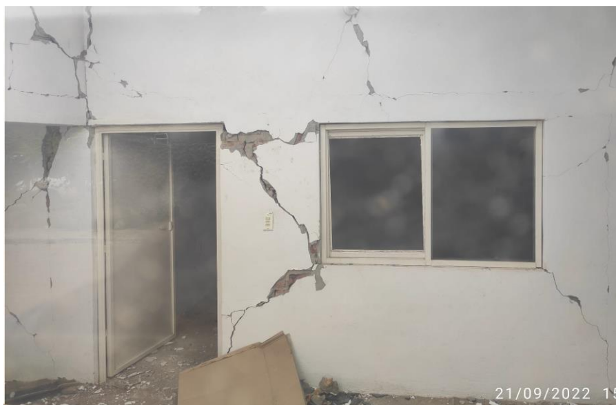
Figura 9.8 Segmento de muro con concentración de fuerza cortante. Fuente: CENAPRED (2022)
