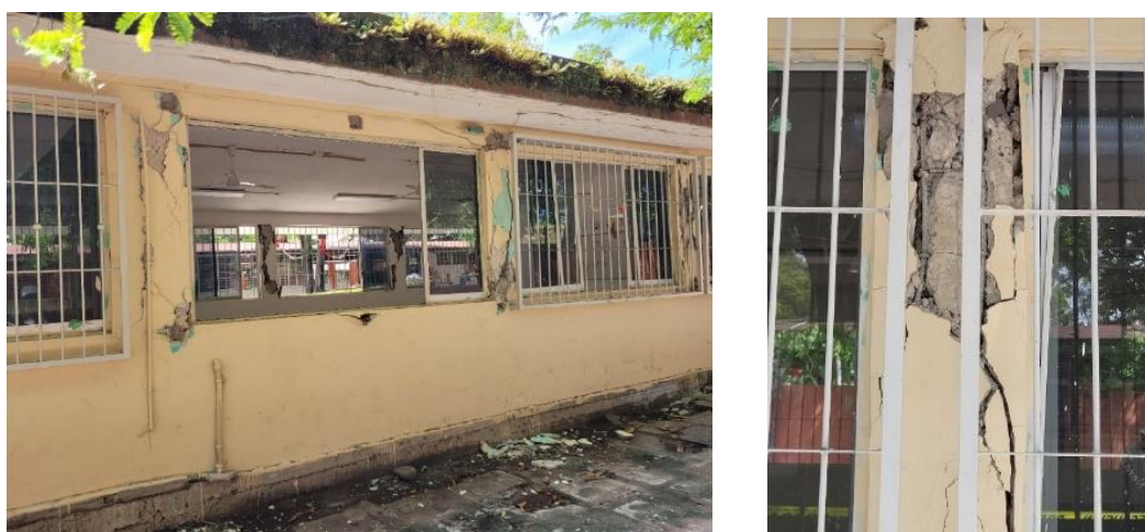
Figura 4.9 Agrietamientos por cortante en columnas y muros
