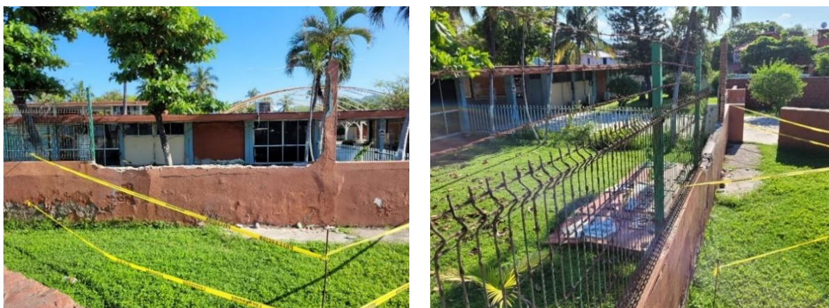
Figura 4.8 Volteo de barda perimetral y colapso del letrero de identificación de la escuela
