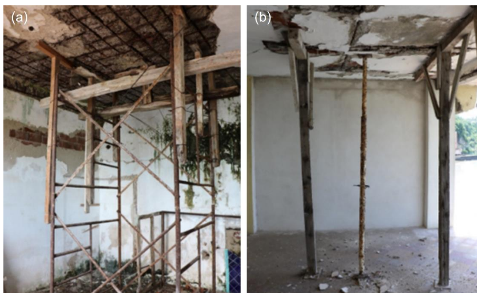
Figura B8. Apuntalamiento que pudo haber evitado el colapso de una sección del edificio. Se observa desprendimiento de materiales por acción del sismo. Hotel Anita
