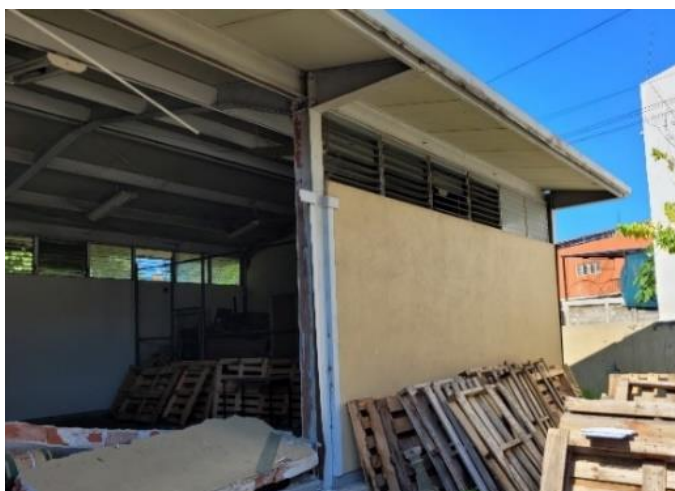
Figura 4.5 Edificio en donde los muros longitudinales presentaron comportamiento fuera del plano
