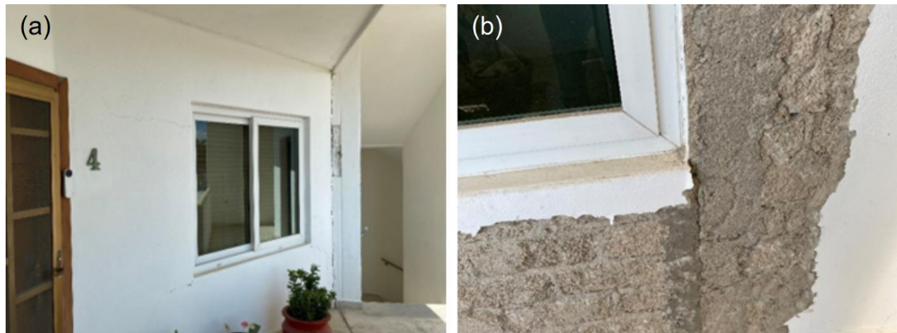
Figura B14. a) Grietas presentes en ventanas y b) retiro del recubrimiento agrietado
