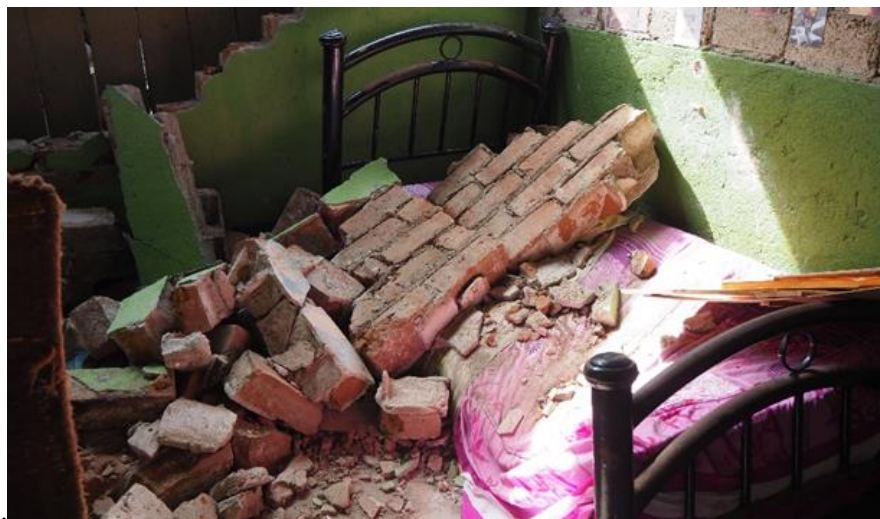
Figura 3.31 Volteo de muro en el interior de una habitación
