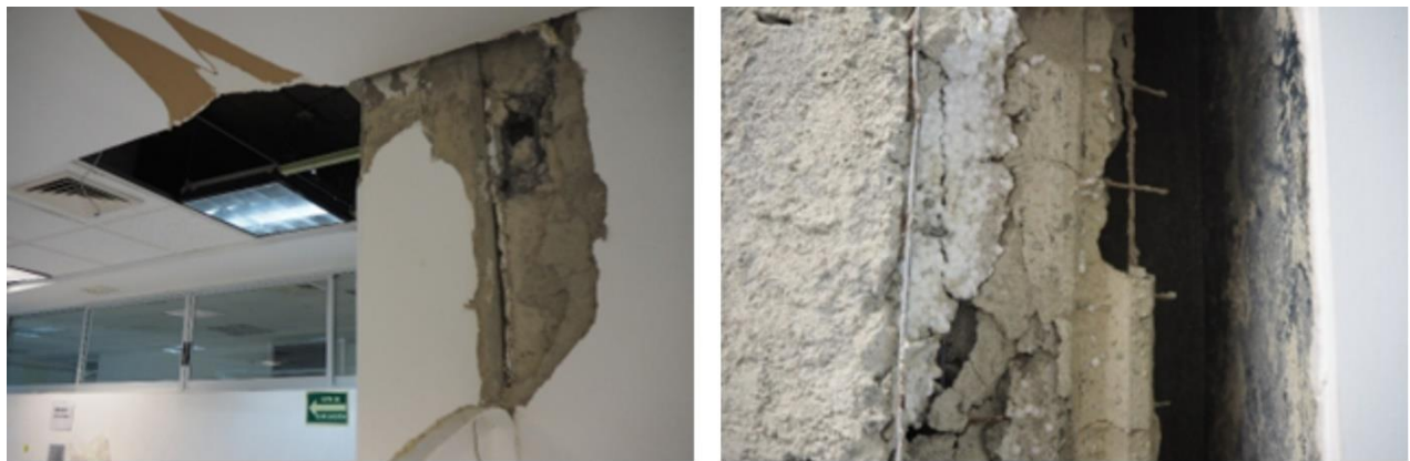
Figura 3.13 Daños en muros no estructurales al interior del laboratorio
