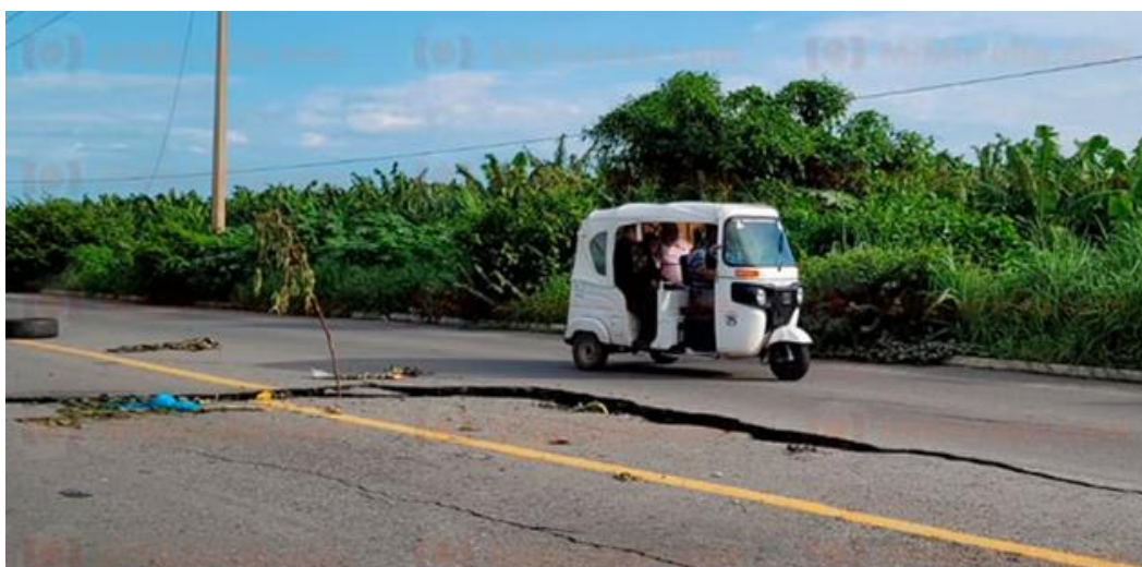
Figura 3.23 Profuso agrietamiento en terraplenes de acceso al puente Coahuayana (Mi Morelia, 2022)
