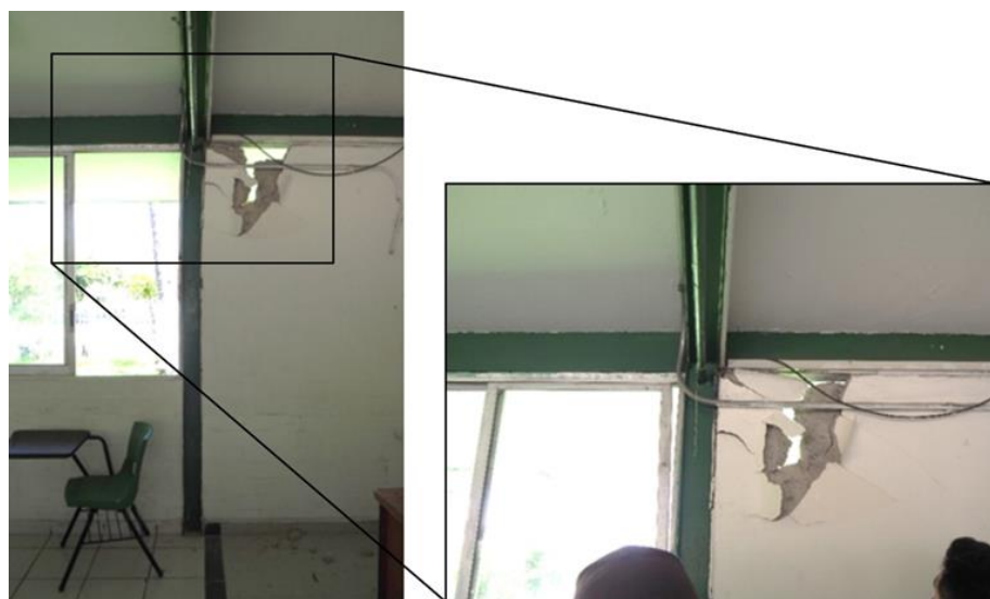
Figura 3.2 Deformación lateral de la porción superior de una columna y fracturamiento del panel aledaño
