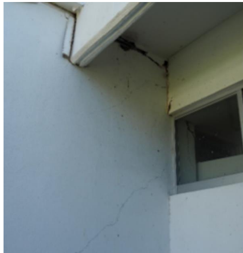
Figura 3.18 Asentamiento y agrietamiento en muro estructural del lado oeste del edificio
