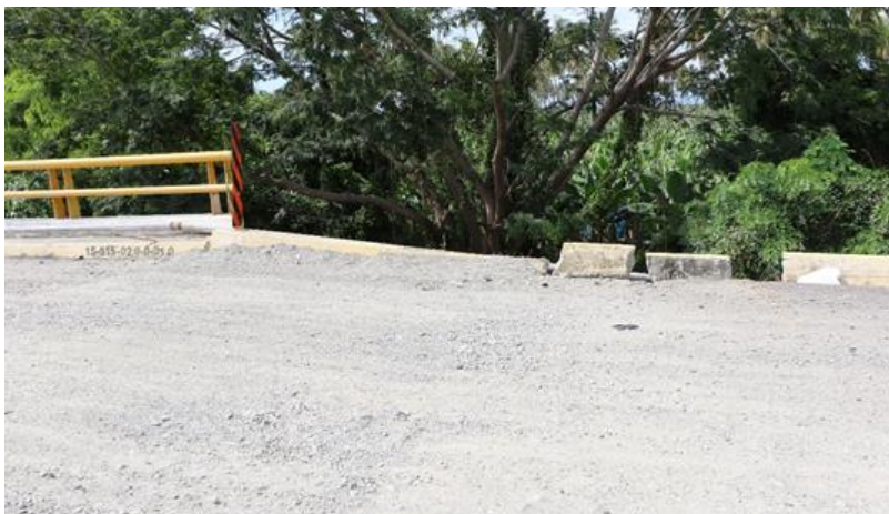
Figura 3.27 Falla incipiente del terraplén de acceso por debajo del estribo del puente El Ticuiz (dirección longitudinal del camino) que se manifiesta como un asentamiento del pavimento
