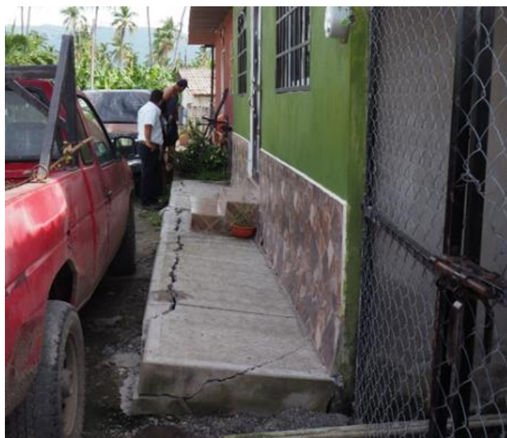
Figura 3.32 Asentamiento generalizado en vivienda y agrietamiento de banqueta contigua
