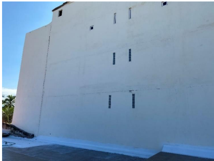
Figura B15. Grietas en muros colindantes
