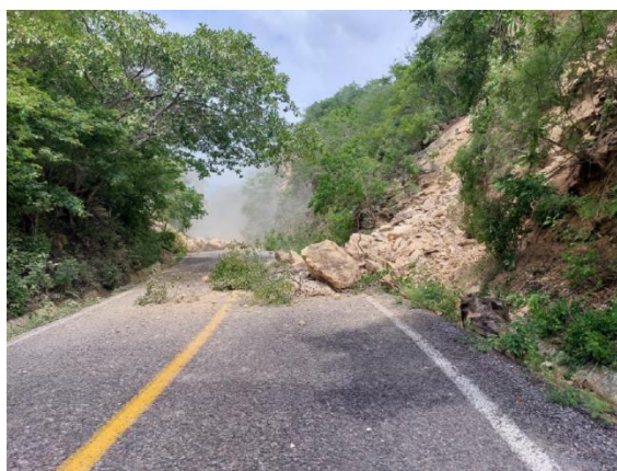
Figura A.6 Derrumbe en la carretera Playa Azul-Manzanillo (SICT, 2022)
