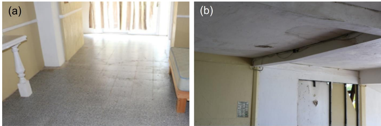
Figura B6. a) Agrietamiento en la losa de una habitación y b) y pandeo en las vigas que la soportan. Hotel Anita
