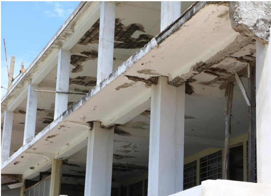
Figura B7. Daños estructurales por deterioro y puntales usados para mantener en pie algunos sectores de la estructura, del Hotel Anita
