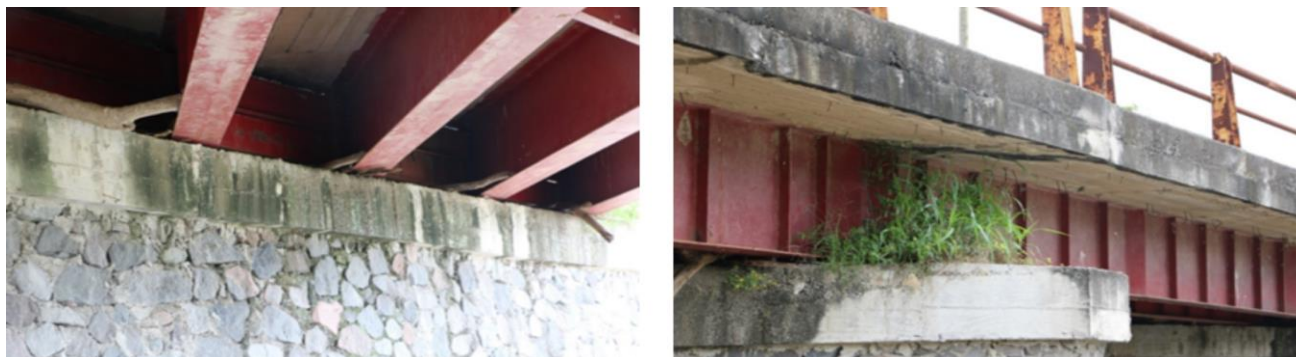
Figura 3.20 Apoyo de las traves que sufrieron el desplazamiento longitudinal
