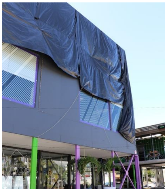
Figura B16. Daño en fachada del gimnasio
