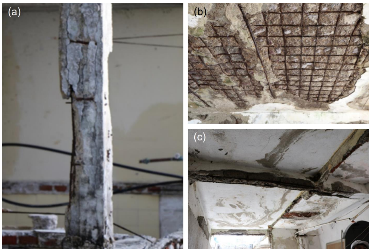
Figura B10. Daños estructurales por deterioro
