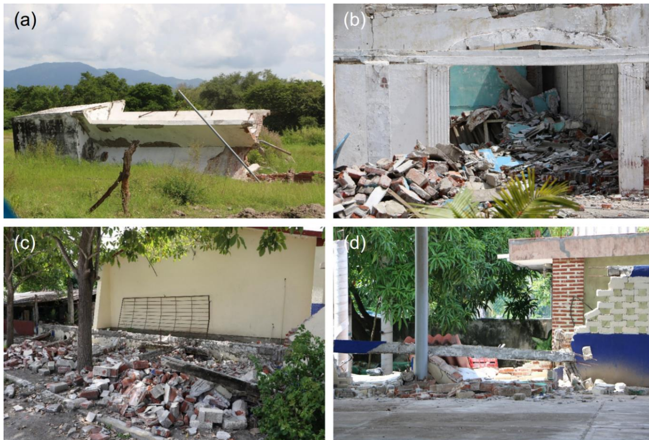
Figura 3.38 a) Tanque elevado volteado, b) estructura desplomada y bardas de una escuela derrumbadas, c) hacia la vía pública y d) hacia el interior de la escuela
