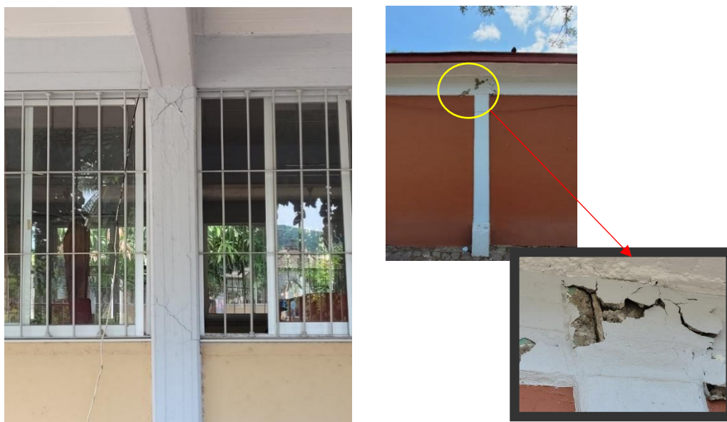
Figura 4.3 Agrietamientos por cortante en columnas y pérdida de recubrimiento en nudos
