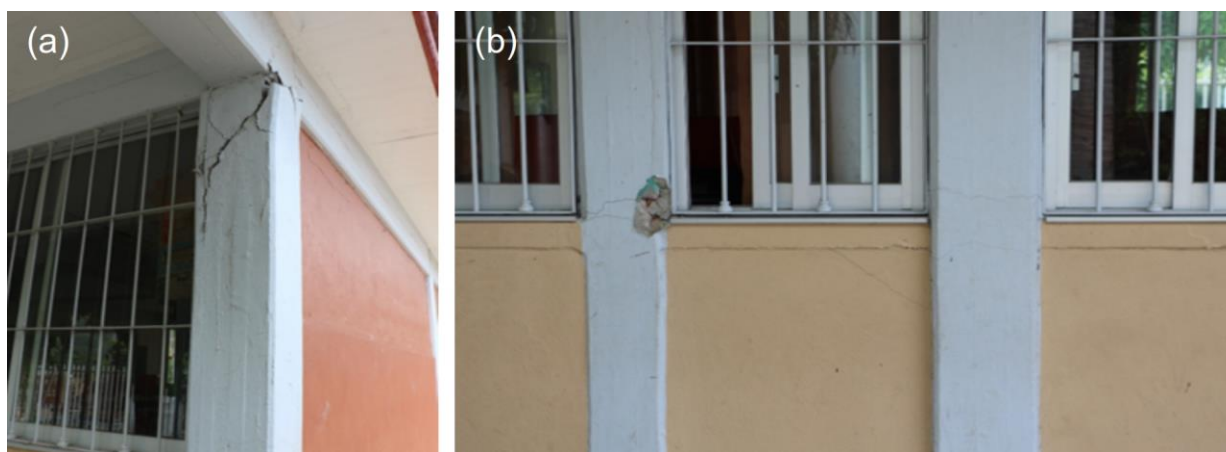
Figura B19. Daños en escuela secundaria en Pueblo Juárez, Colima
