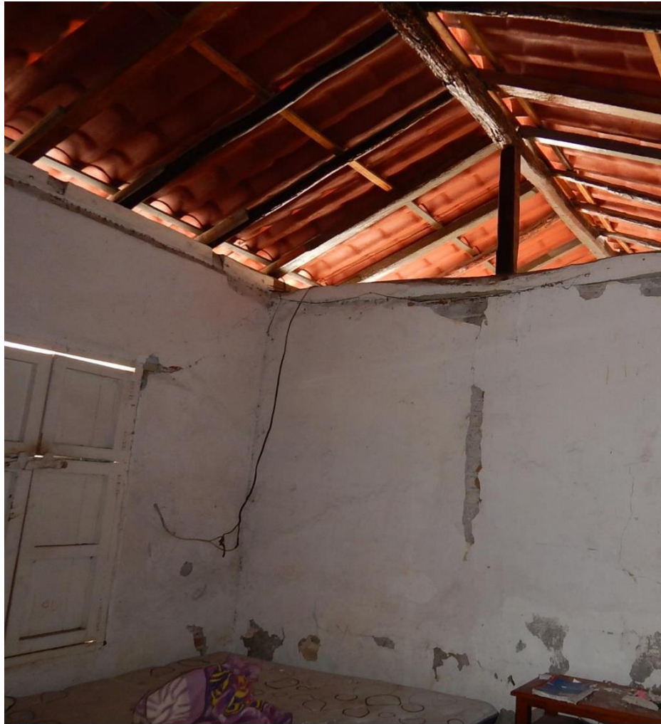
Figura 9.2 Vivienda, deformación fuera del plano de uno de los muros con daños debidos a flexión cerca de la base. Fuente: CENAPRED (2022)
