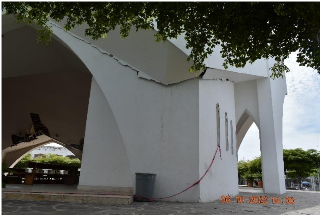
Figura 5.11 c) Daño en uniones muro – techo (continuación)
