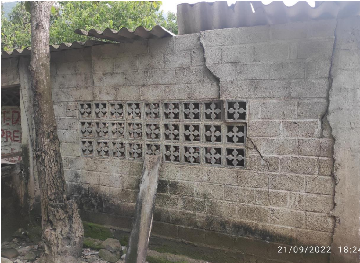
Figura 9.5 Muro con abertura rellena de celosía, daño fuera del plano. Fuente: CENAPRED (2022)
