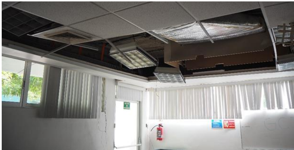
Figura 3.12 Daños en instalaciones al interior del laboratorio
