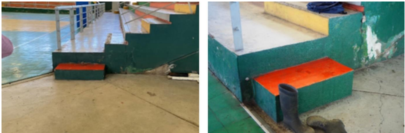
Figura 3.6 Agrietamiento de cancha y primera fila de grada Sur en extremo Oeste
