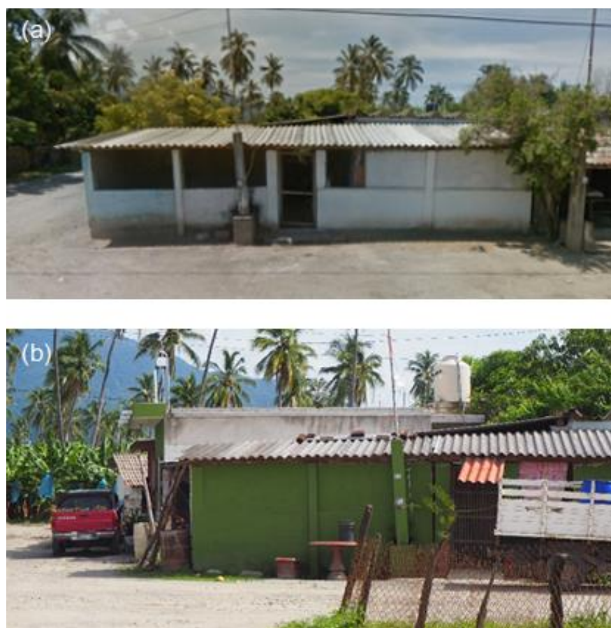
Figura 3.30 Asentamiento diferencial en vivienda y consecuente agrietamiento. a) antes del sismo y b) después del sismo. Fuente a): Google, 2014
