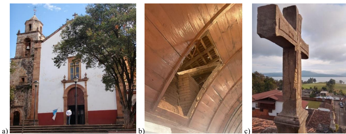
Figura 5.7 Iglesia de Zirahuén: a) fachada principal, b) daño en bóveda, c) daño en cruz de fachada
