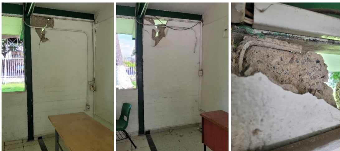
Figura 4.14 Daños en muros de relleno para cubrir aberturas de ventanas en aulas de acero estructural
