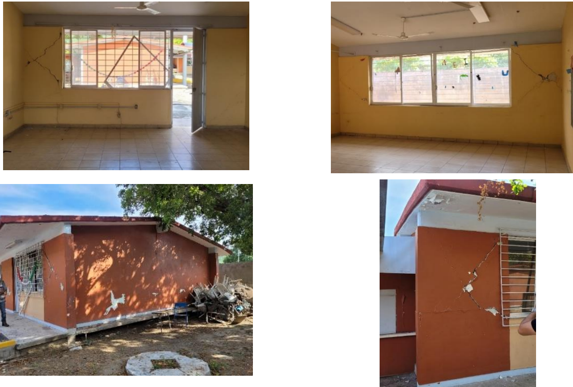
Figura 4.12 Daños por cortante en muros de mampostería (continuación)
