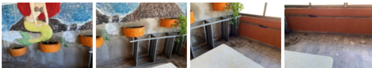
Figura B13. Grieta en muro de colindancia que continúa hasta el piso
