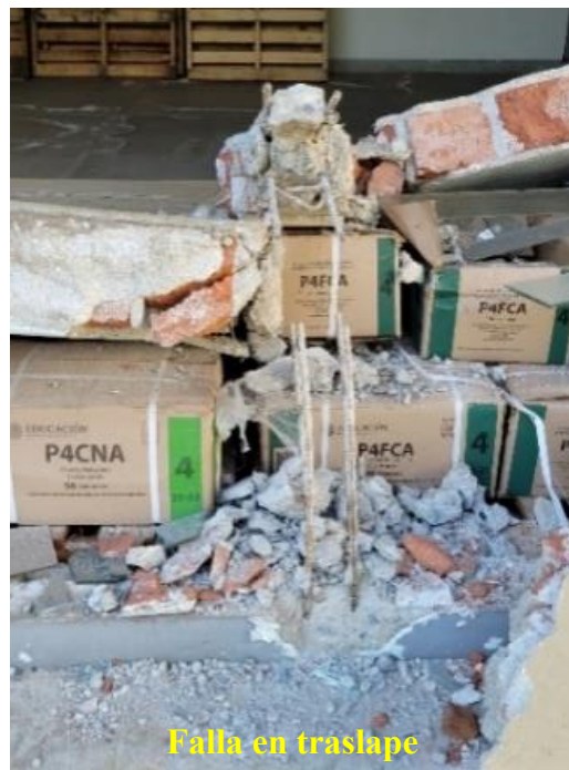
Figura 4.6 Volteo de muro longitudinal por deficientes elementos de sujeción e inadecuados traslapes en el acero de refuerzo longitudinal
