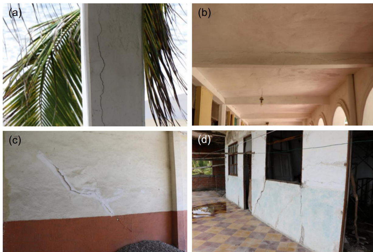
Figura B4. Daños (a y b) estructurales y (c y d) en muros por el sismo
