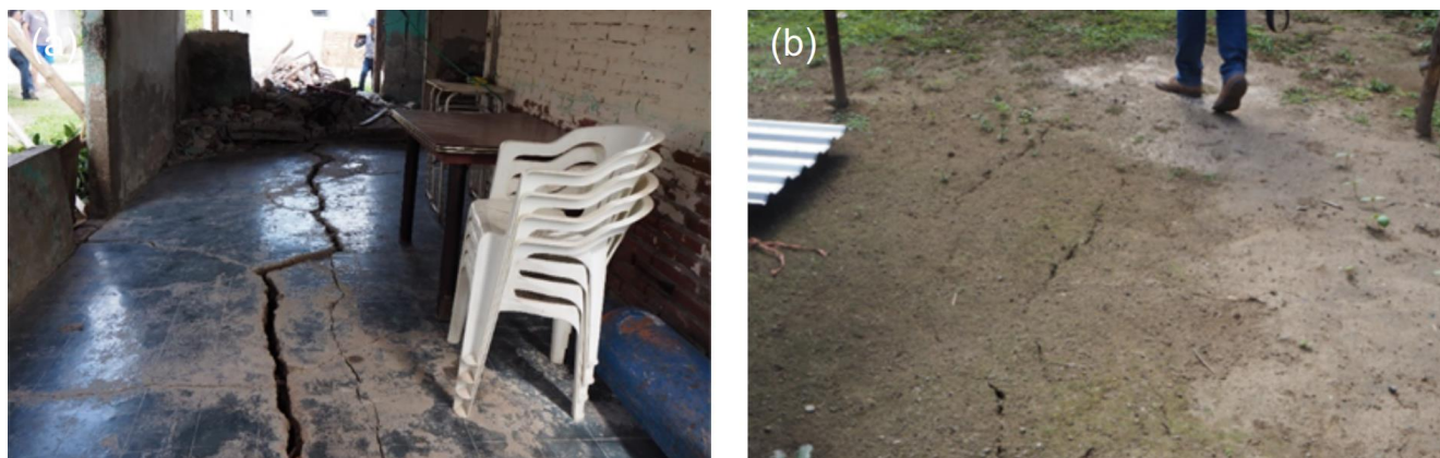
Figura 3.33 a) Abultamiento y fracturamiento en el piso y b) agrietamiento del terreno con arrastre de arena a la superficie
