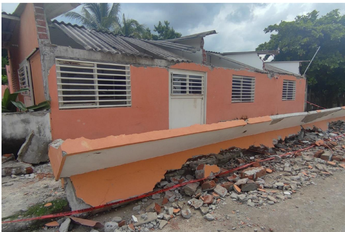
Figura 9.11 Desprendimiento de pretil, por falta de castillos
