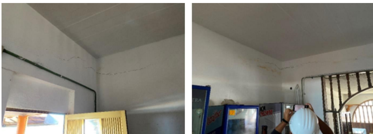
Figura B12. Grietas no estructurales
