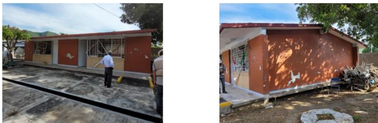
Figura 4.12 Daños por cortante en muros de mampostería ( continúa )
