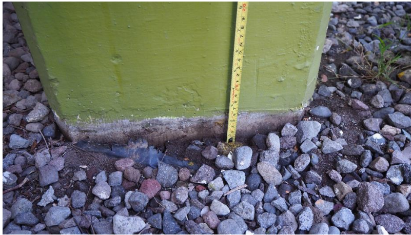
Figura 3.17 Asentamiento del terreno alrededor de algunas columnas del edificio
