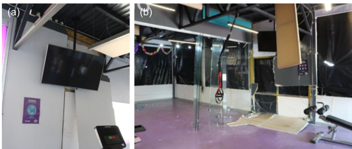
Figura B17. Desprendimiento de plafones y rotura de cristales
