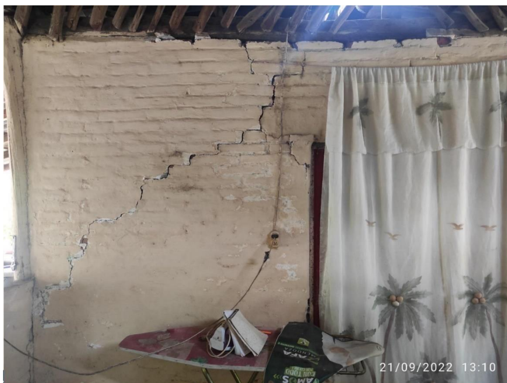
Figura 9.1 Agrietamiento por tensión diagonal, techo de madera. Fuente: CENAPRED, 2022
